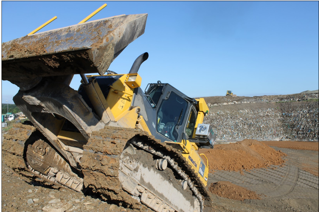
Im Gelände der Deponie Krölpa ist unterschiedliches technisches Gerät im Einsatz. Mitunter sieht das recht wagemutig aus. Lesen Sie mehr auf Seite III.
