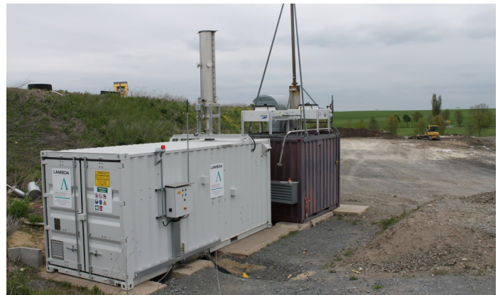
Schwachgasfassungs- und Behandlungsanlage
